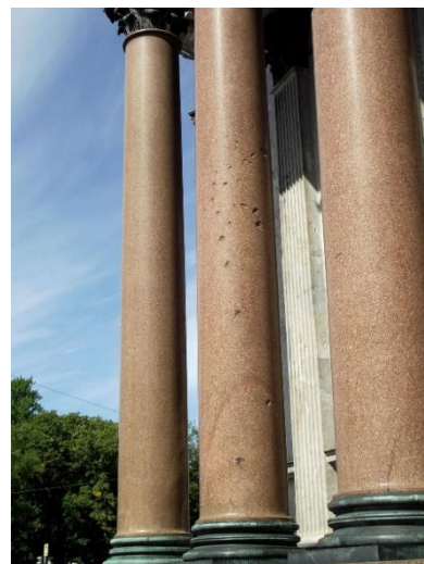
Рис. 5. Следы артобстрелов на колоннах Исаакиевского собора
